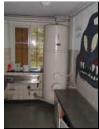
Alter Elektroboiler im Abwaschraum.
