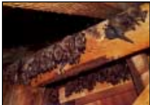
Fledermäuse im Dach
