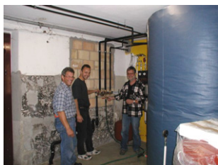
Technikraum mit Wärmespeicher
